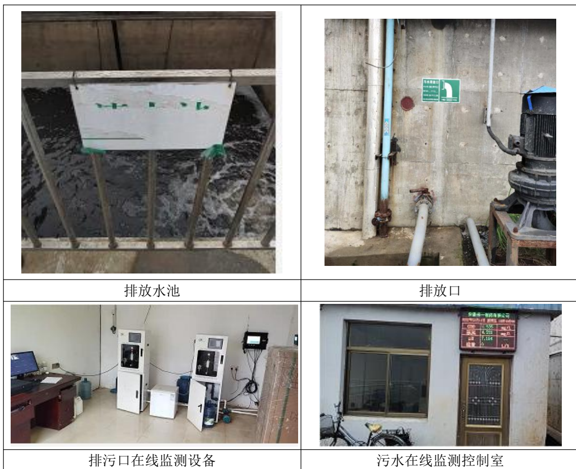
3.4.2-2 污水站处理现状图
